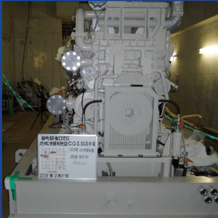
写真1 更改したガスエンジン
